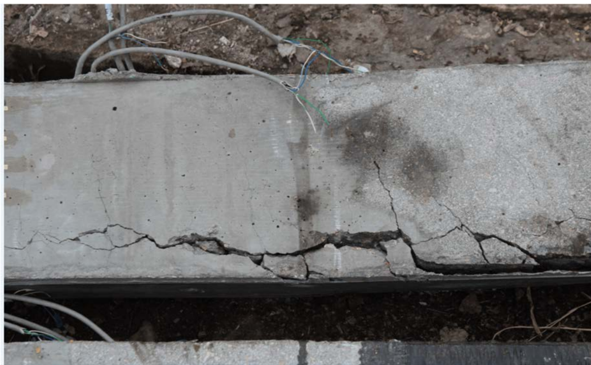
Рис. 3.11. Фрагмент зоны разрушения балки БП-2-3с
