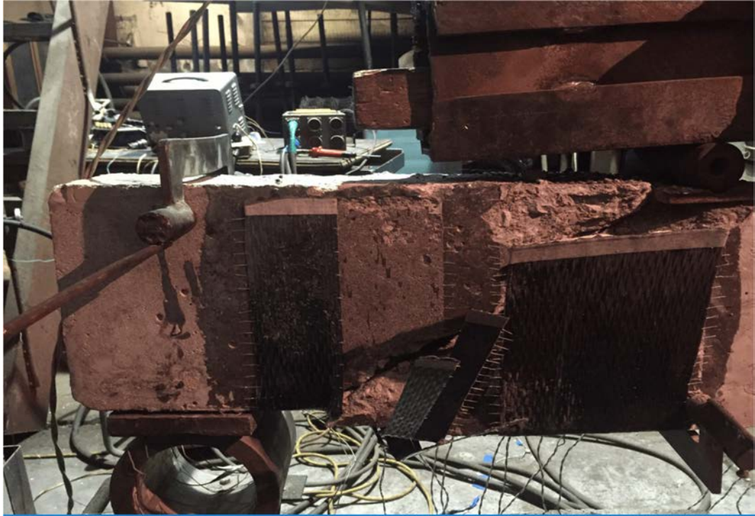
Рис. 3.20. Фрагмент разрушение опорной зоны балки BQ11-2
