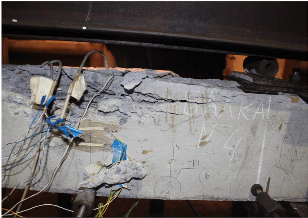
Рис. 3.12. Разрушение зоны чистого изгиба балок III партии
