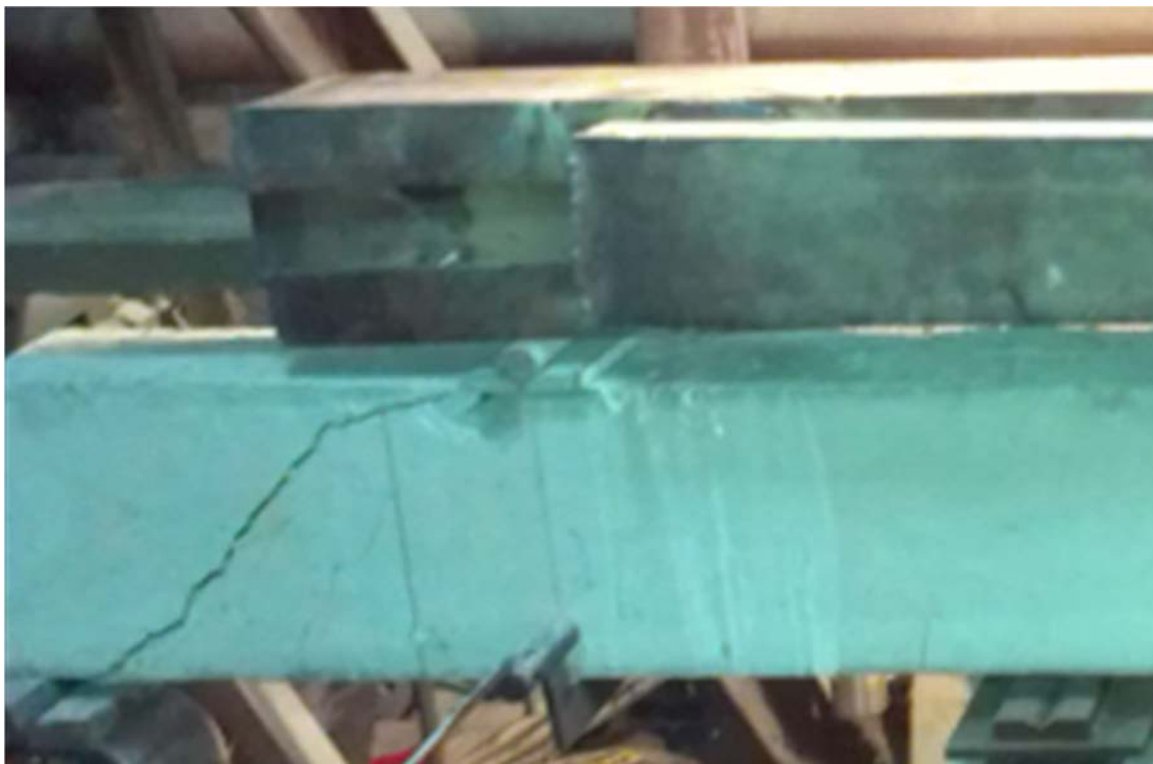
Рис. 3.16. Разрушение по поперечной силе балки, не имеющей поперечной арматуры в опорной зоне
