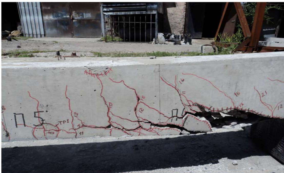
Рис. 3.3. Участок разрушения в зоне чистого изгиба балки, усиленной в растянутой зоне ламинатом
