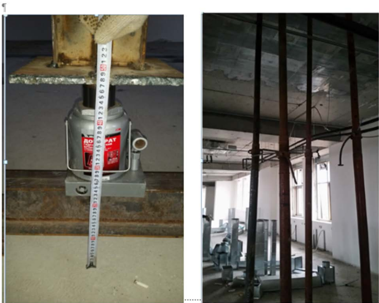
Рис. П.1.4.4. Общий вид домкрата со стойкой и временных опор при усилении перекрытия здания на пр. Сейфуллина
