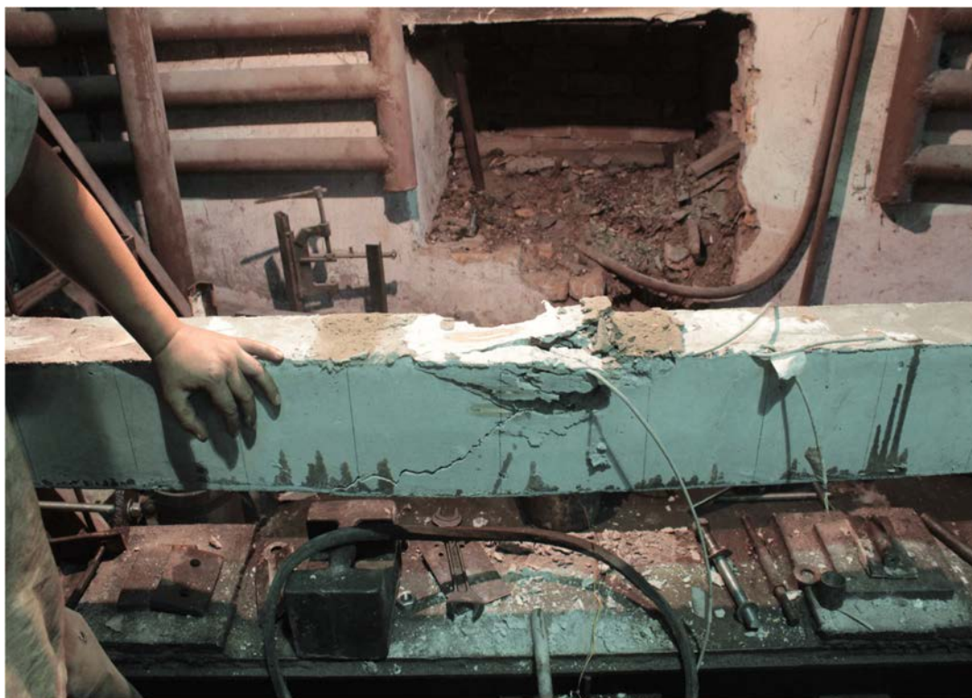
Рис. 3.5. Вид сверху участка поврежденного защитного слоя бетона балки
